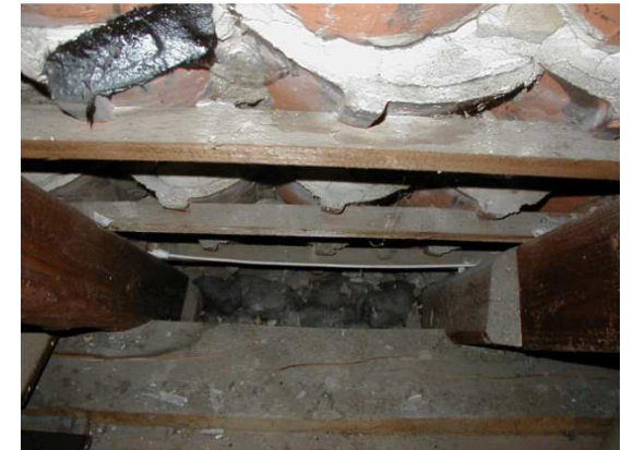
Blick von oben in die ungedämmte Dachschräge
