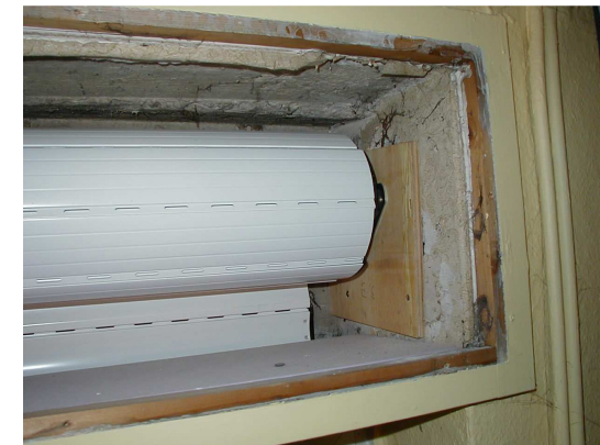
Hier befindet sich die (eis)kalte Außenluft!
